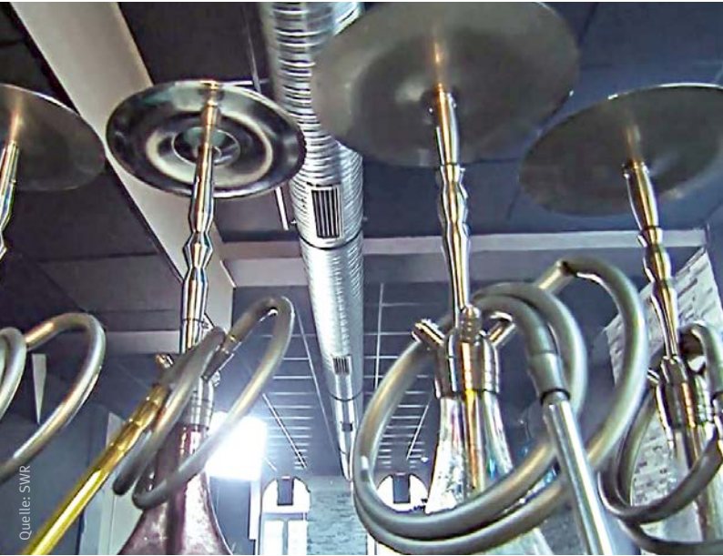
Gastraum mit Lüftungsanlage
