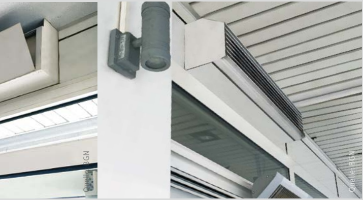
Beheizte Zuluftanlage (Innen- und Außenansicht)
